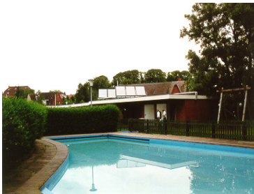
Solarthermieanlage Treenebad Schwabstedt
